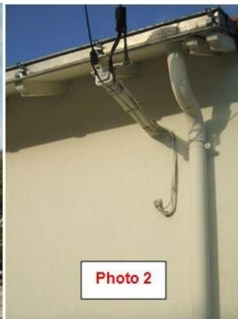
Pénétration du câble de branchement aérien dans le local
